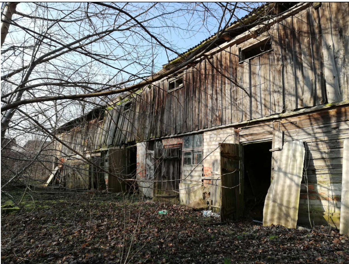
Nr. 4 Pavadinimas Rytų fasado fragmentas – avarinės būklės statinio pietinė dalis Fotografavo Inga Jablonskė Data 2020-03-06
